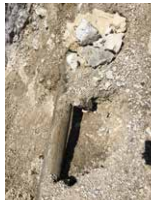
Abb. 4: Unterspülung einer Wegbefestigung vom oberen Soiernhaus zur Schöttelkarspitze.
